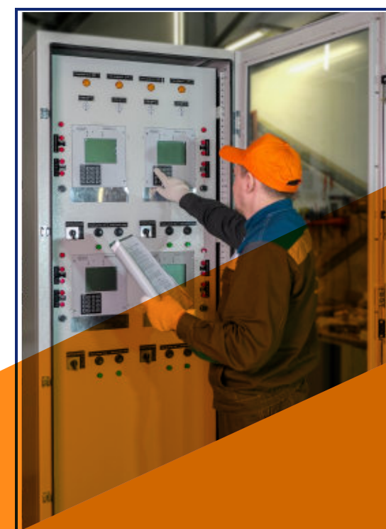
Рис. 6. Шкаф управления 4-мя дугогасящими реакторами Энерган 1.4
